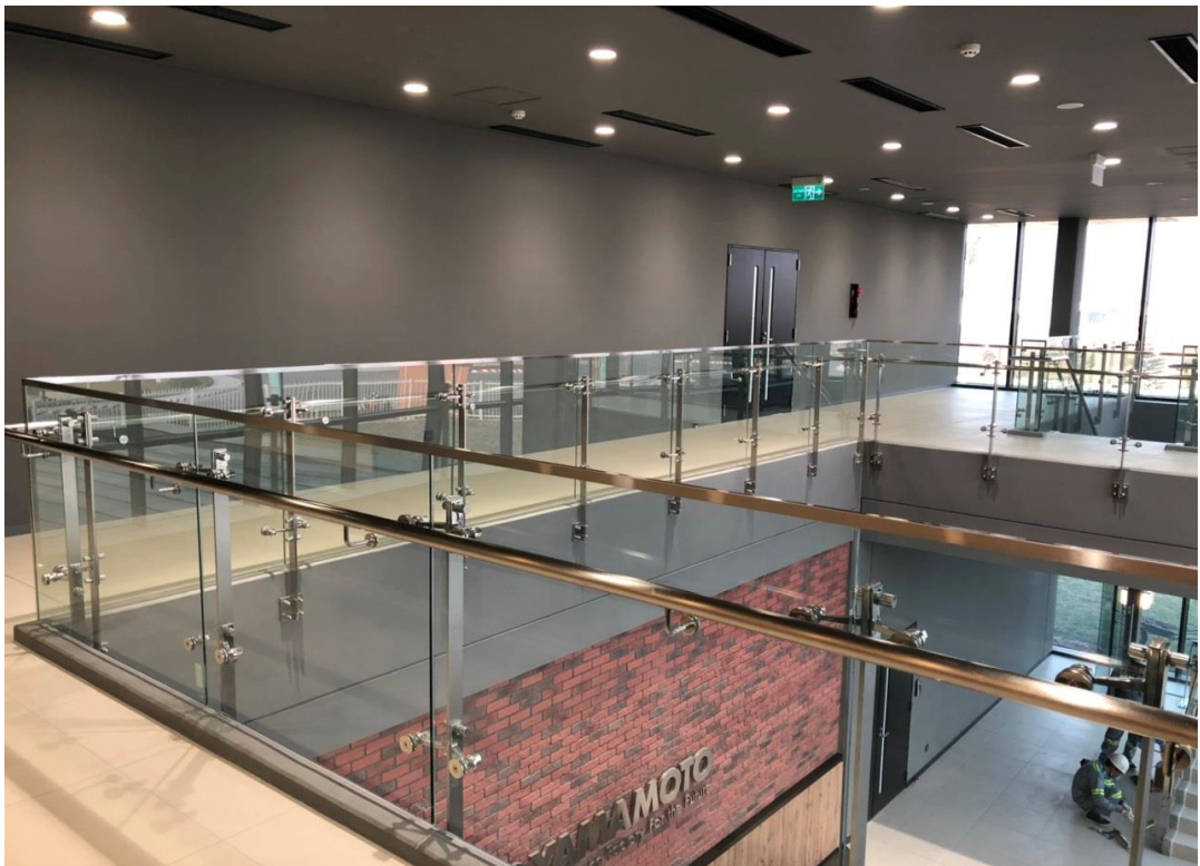
Hạng mục Lan can kính – Dự án Nhà máy Yamamoto Việt Nam Category: Glass railing – Yamamoto Vietnam Factory Project
